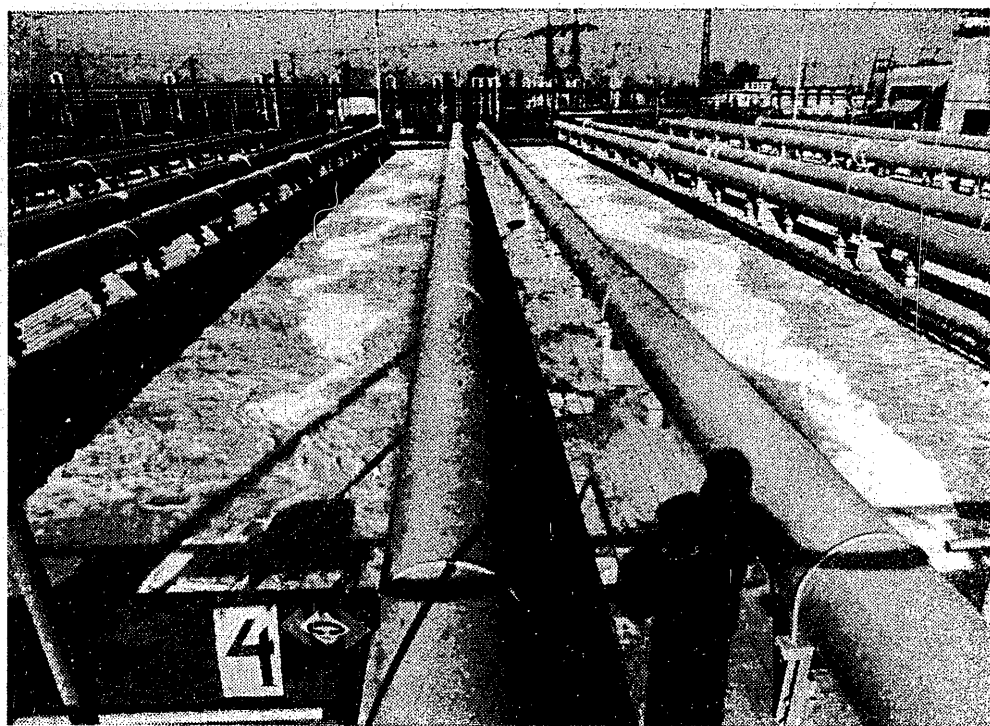
Oczyszczalnia ścieków przemysłowych w tarnowskich „Azotach”
